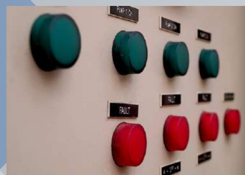
Painel de comando
